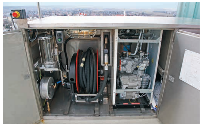
Betankungsanlage mit Jet A-1
